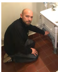
Pontus Asp har besiktat många våtrum för att förebygga skador.
